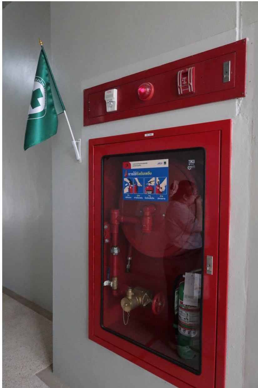
ระบบและอุปกรณ์ความปลอดภัยด้านอัคคีภัยประจำอาคาร
